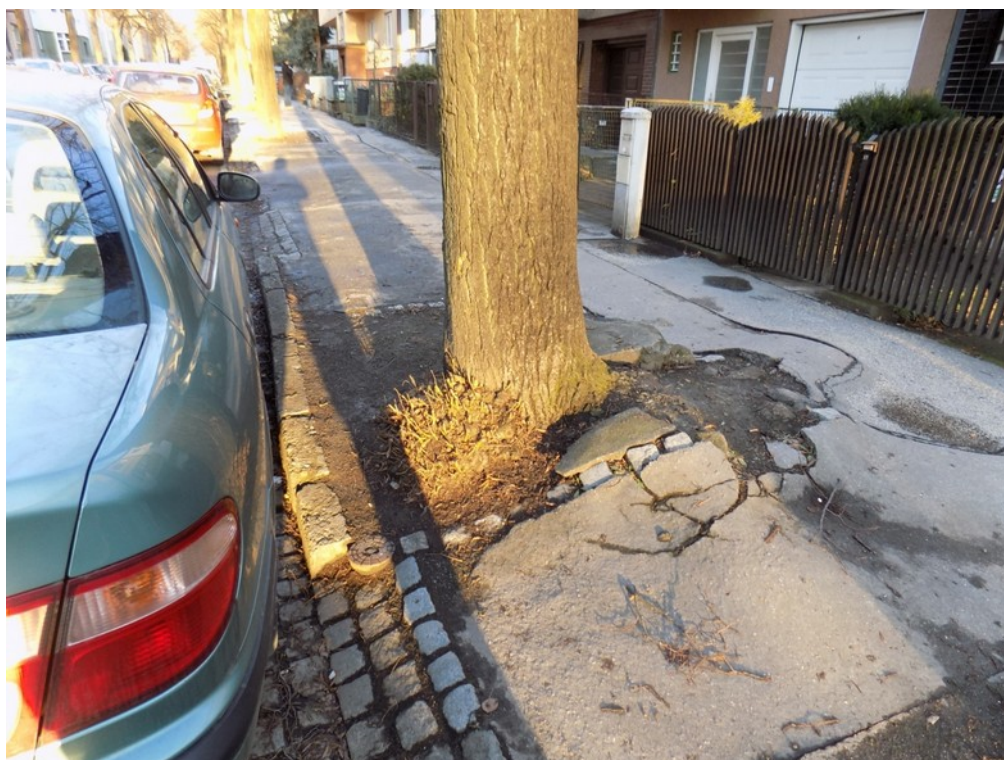
Obr. 4: Další snímek typického stavu kořenové mísy
